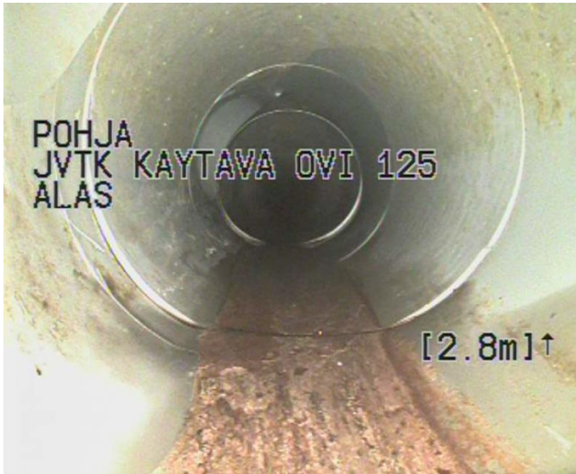
Kuva 10. A-osan käytävä, pohjaviemärissä lievästi betonipitoista tuotetta.
