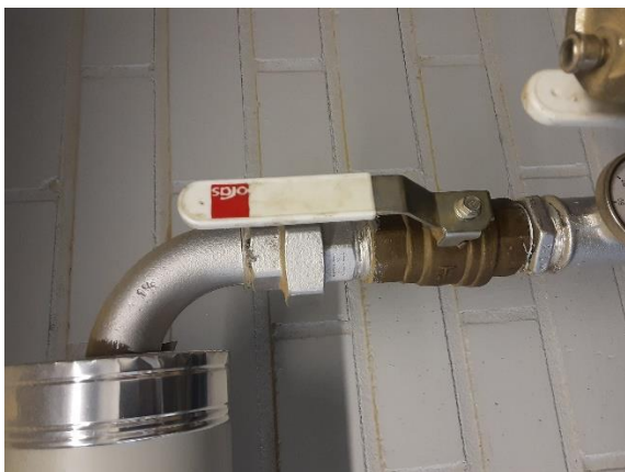
Kuvat 12. Lämmitysverkoston venttiili
